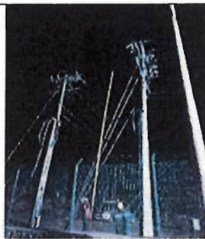
Energización alimentador #2 y #4.
