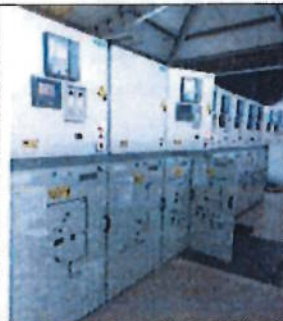
Celdas instaladas y energizadas.
