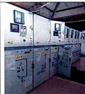
Celdas instaladas y energizadas.
