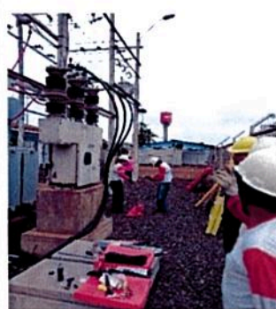
Conexión alimentador Caterpillar en k05.
