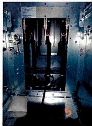
Conexión del alimentador #5 en la celda k08
